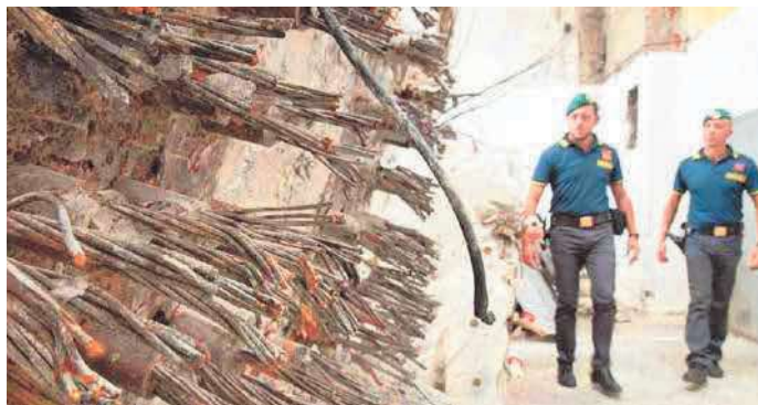
I cavi in acciaio che erano il cuore del Morandi. I detriti oggi sono oggetto dell'inchiesta giudiziaria
